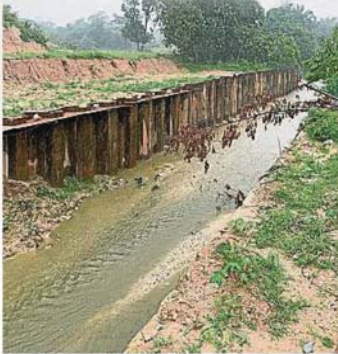
政府必須在河堤處加設鋼條，防止泥土流失的狀況惡化。
